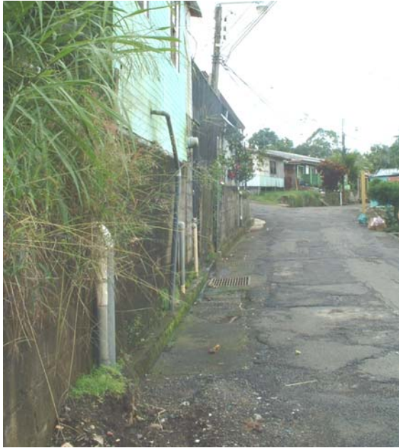
Imagen 14: Conexiones de aguas residual a caño, ubicadas en el barrio conocido como Sector Sur.
